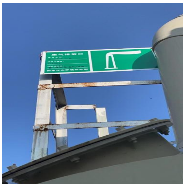
废气排放口标识牌
